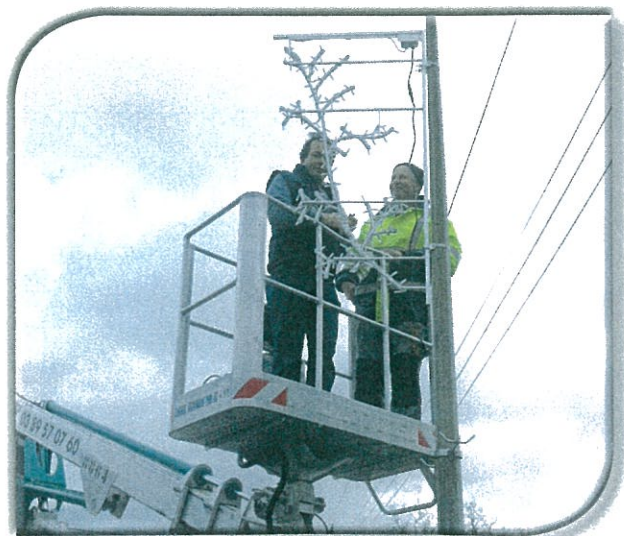
INSTALLATION « MOTIFS LUMINEUX A LED » POUR POTEAUX ELECTRIQUES
